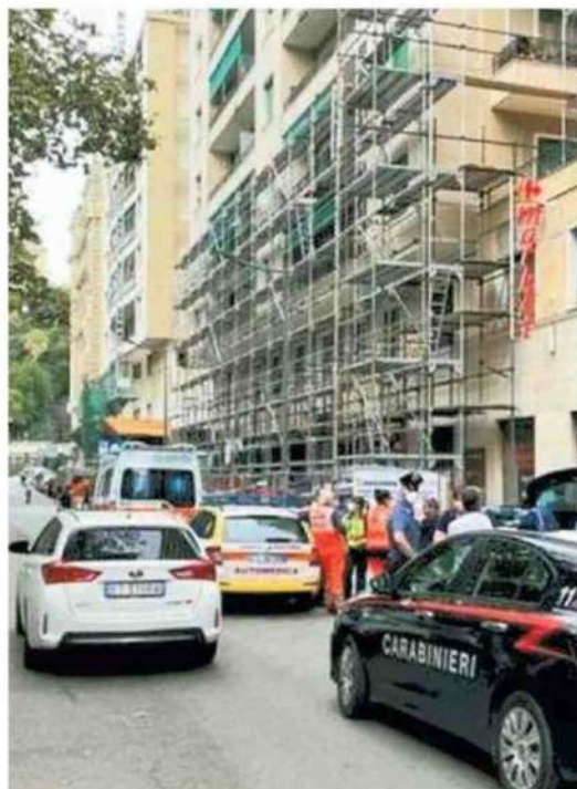
Il cantiere dove è avvenuta la tragedia nel quartiere Foce, a Genova
